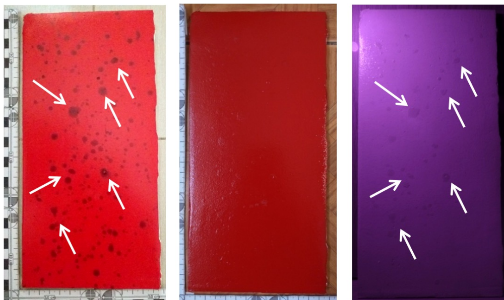
Figura 9. Detección en cartón-yeso de manchas por transmisión y absorción del IR. Izq: Muestra EAR3. Medio: Capa 6 EAR3 totalmente cubierta. Derecha: Capa 6 EAR3 incidida con luz IR a 45° y configuración de cámara f/3.4; vel 1/40 e ISO 80.
